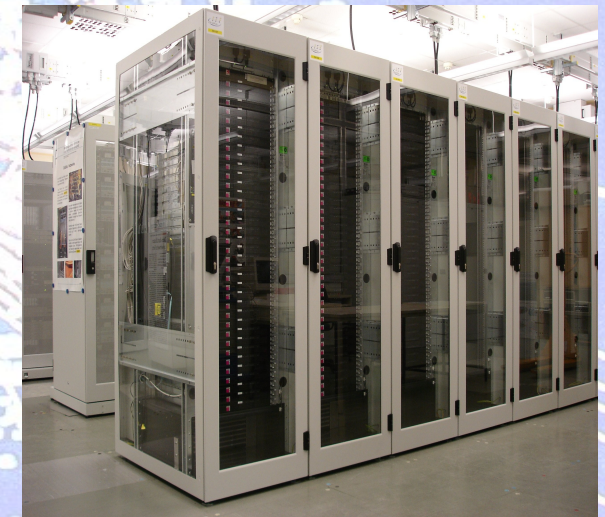
GridKa, Racks mit Arbeitsknoten
